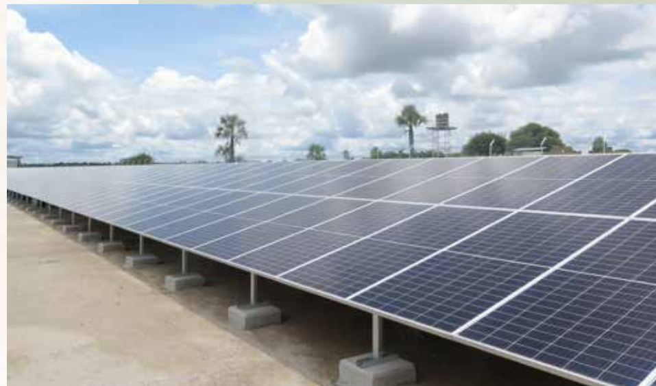
Panneaux solaires pour le pompage de l'eau, dans une ferme agricole, Namibie
